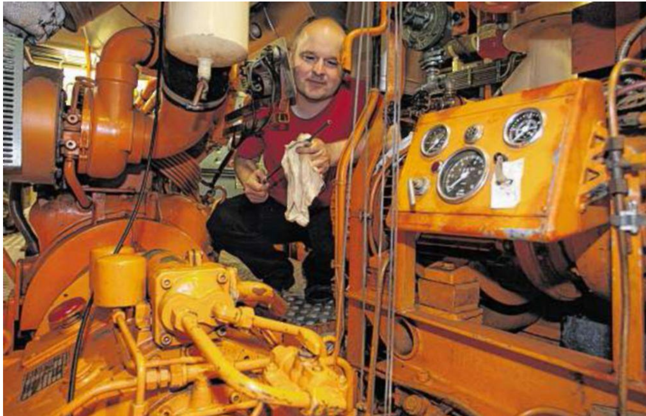
Kai Steffen im Maschinenraum der „Bremen“. Das Traditionsschiff steht seit Dezember 2013 unter Denkmalschutz und soll in den Originalzustand zurückversetzt werden. Doch das bisherige Finanzierungskonzept wackelt. FOTOS: CHRISTIAN KOSAK
